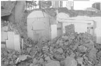
شکل ۱۷: خرابی یک نمونه از سازه بنایی در زلزله
